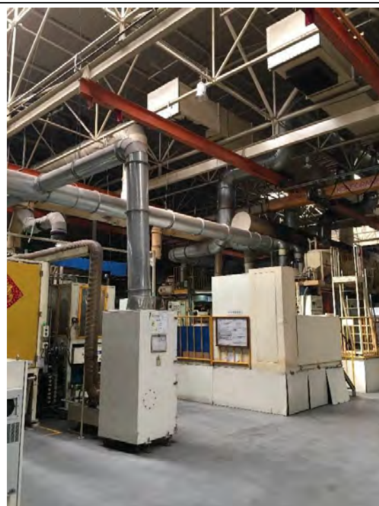
废气处理设施
