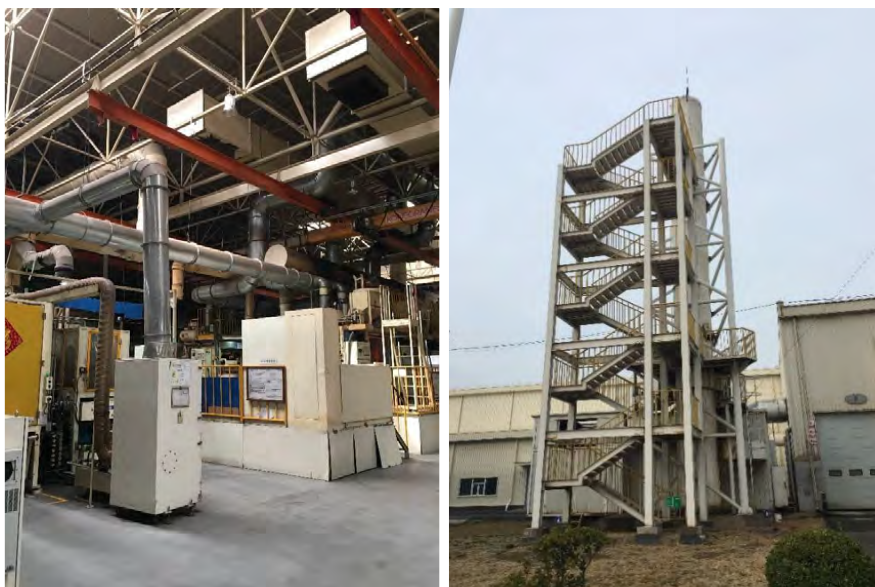
图2.4-8 各类设备自带集尘机及排气筒
