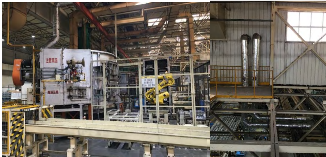
图2.4-3 高压铸造热处理炉及排气筒
