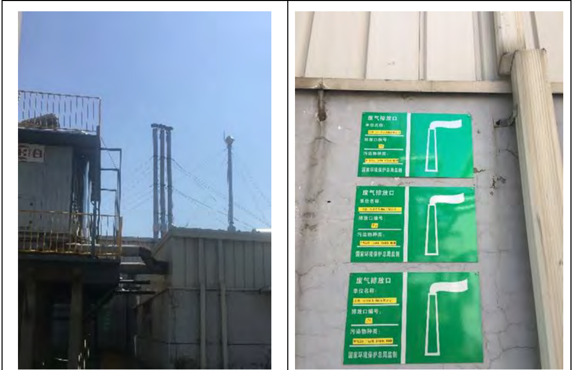
废气排放口（P2/P3/P4/P16）及标识牌
