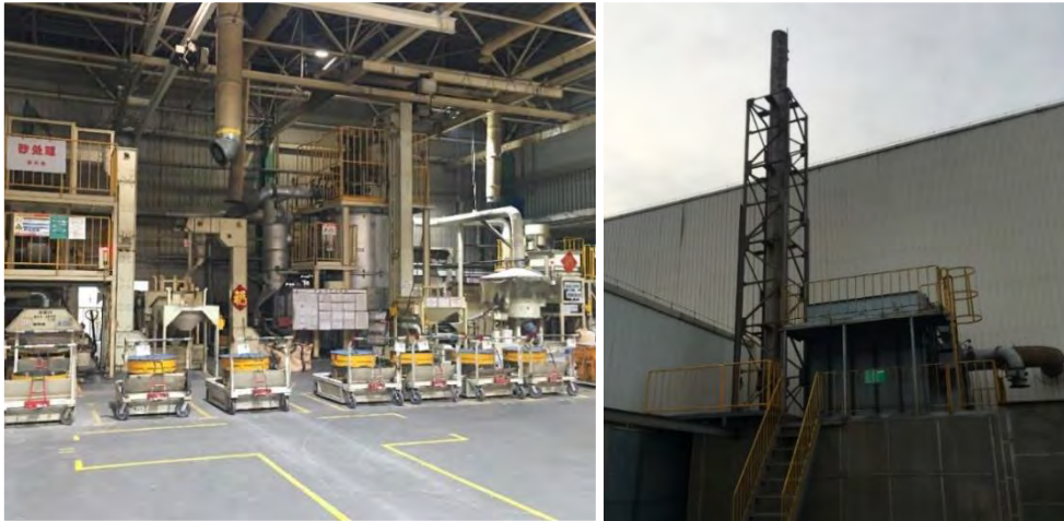
图2.4-12 覆膜型芯砂处理设备及排气筒
