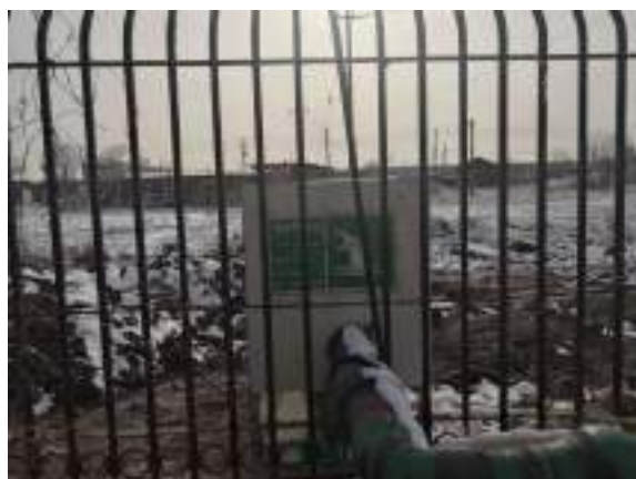
废水排放口及标识牌
