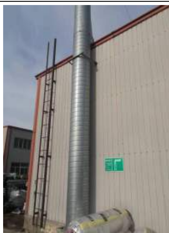
打砂排放口（P3）及标识牌
