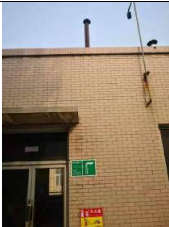
锅炉排放口（P1）及标识牌
