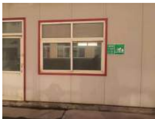
一般工业固体废物暂存间及标识牌
