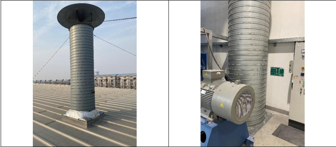
图 2-10 P 4 （大 BB 配料系统）废气排放口监测点位及标识牌
