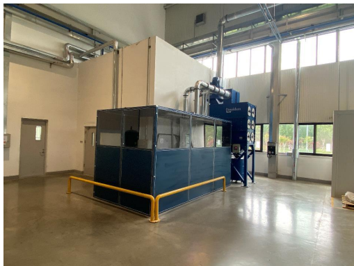
图 2-5 检验室破碎和振动工位密闭除尘室
