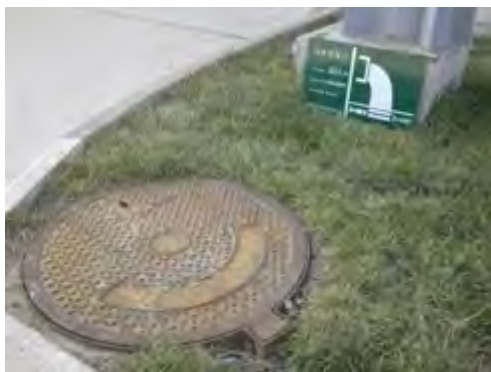
照片 12-7 废水总排口
