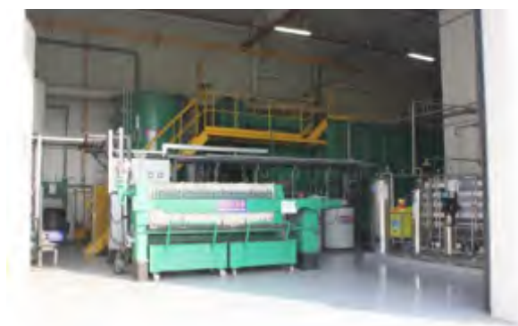
照片 12-16 污水处理设施
