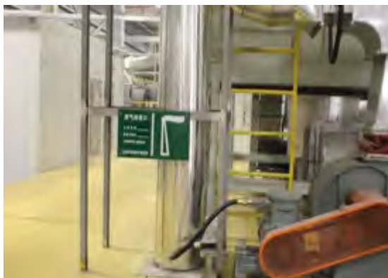
照片 12-13 烘干炉、烤漆房废气排放口 (FQ-KG359)
