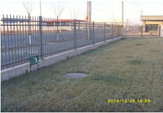
WS-KG241 生活污水总排放口.
